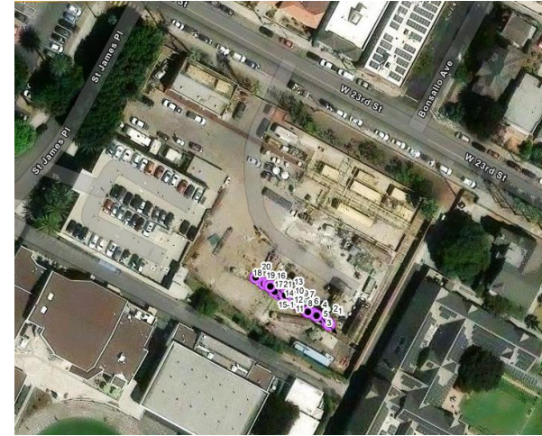
21 wells and onsite tank facility / 21 pozos y una instalación de tanques en el sitio
